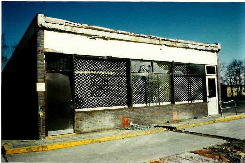
Bild 8 Bauschäden (Gebäude Nr. 34)
