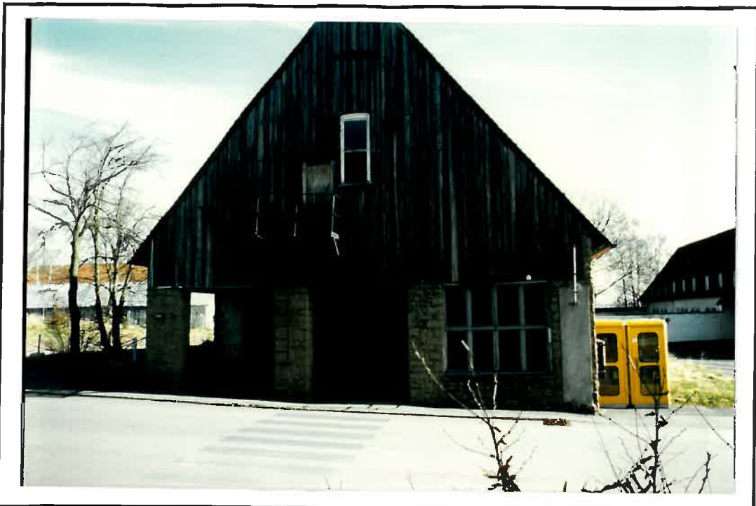
Bild 5 Bauschäden (Gebäude Nr. 1)
