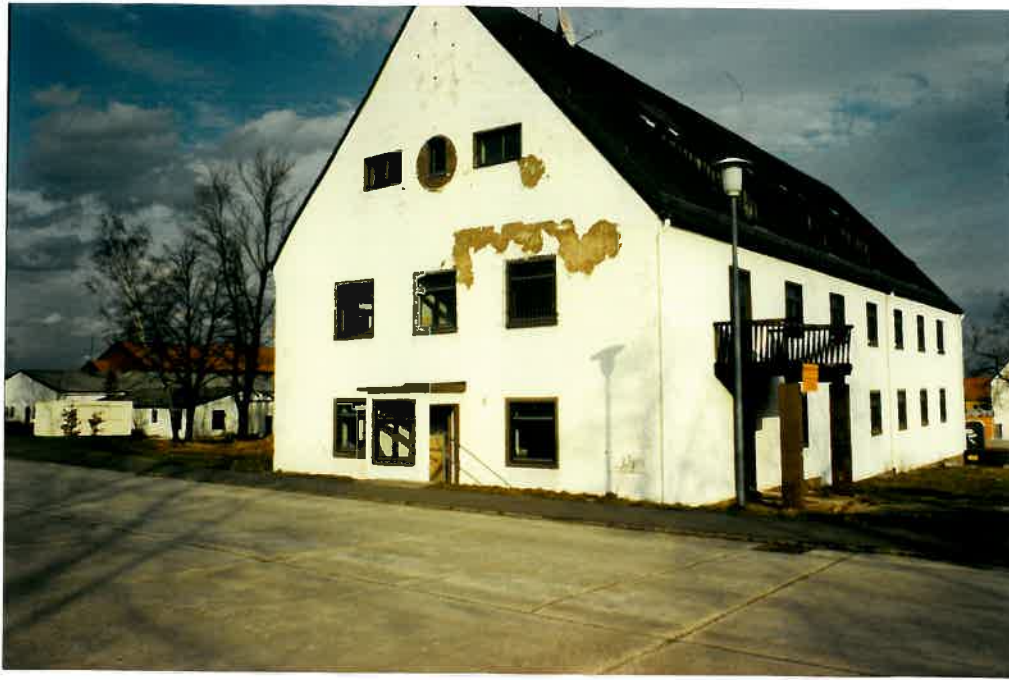
Bild 7 Bauschäden (Gebäude Nr. 25)
