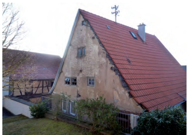
Abb. 17 Gebäude mit Sanierungsbedarf
