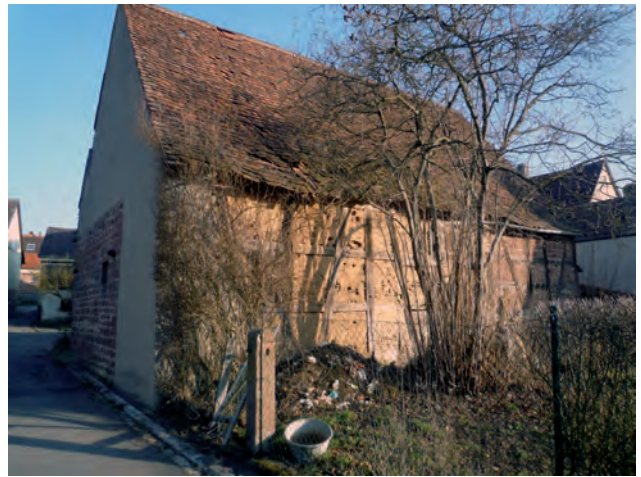
Abb. 45 Scheune, Bauzustand mangelhaft
