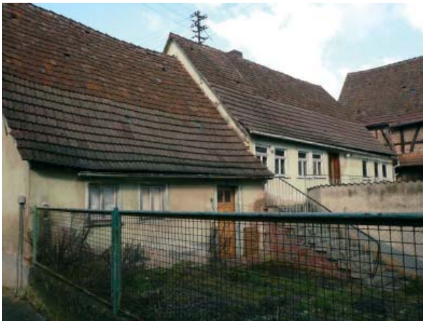
Gebäude Obere Straße 33+35 in schlechtem Zustand
