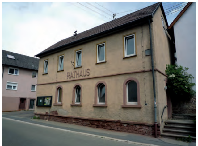
Abb. 45 Altes Rathaus, Sanierungsbedarf
