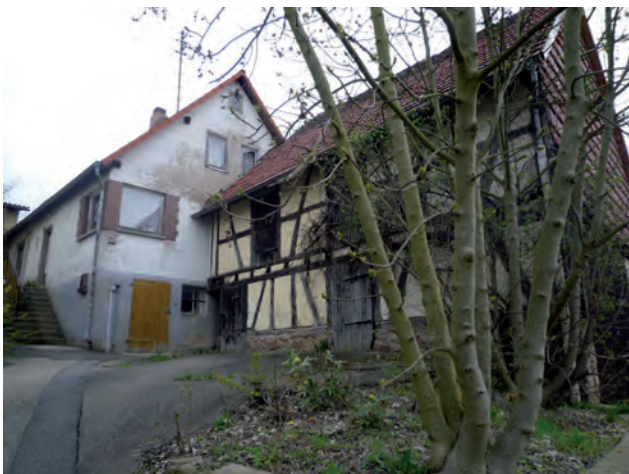
Abb. 12 Bausubstanz in schlechtem Erhaltungszustand
